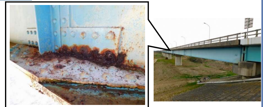
主桁腐食事例
