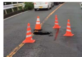
道路の陥没事例
