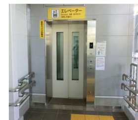
障害者対応型エレベーター
