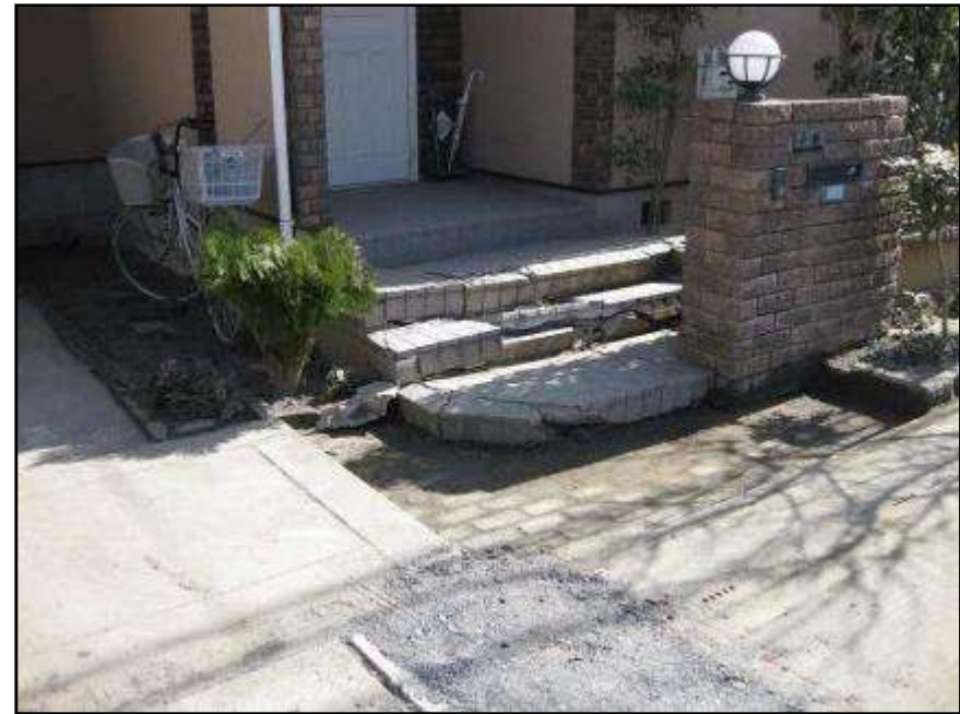
沈下による階段の破損
