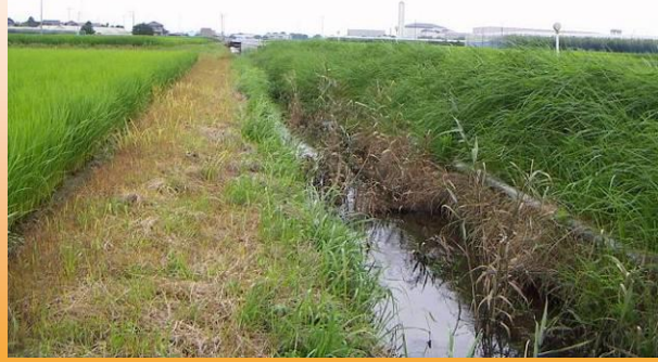
法面が崩れ雑草が茂っている状況 (H21.6撮影)
