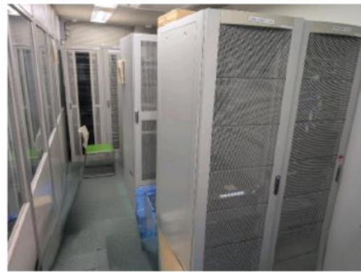
河川砂防課サーバールーム
