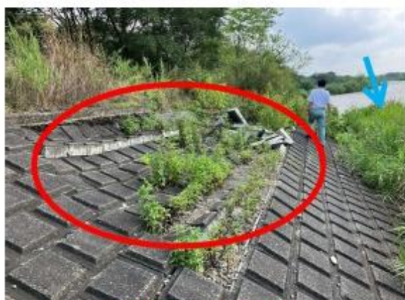
護岸ブロックの破損
