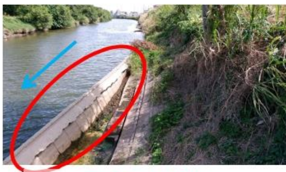
護岸ブロックの傾倒
