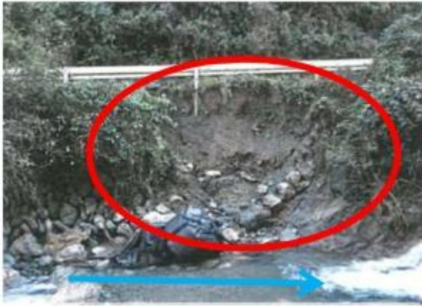
石積護岸の崩落
