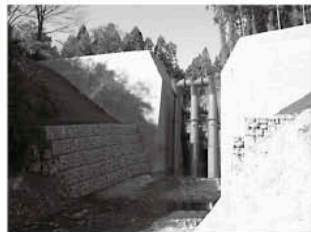
土砂災害防止施設の整備(ときがわ町)
