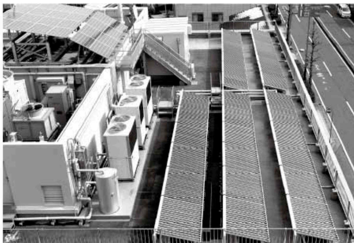
ビルに設置された太陽熱集熱装置
