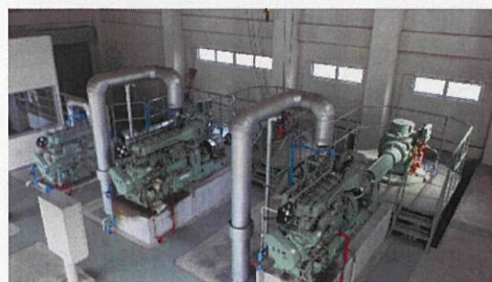
補修整備された排水ポンプ （吉見町 南吉見排水機場地区）
