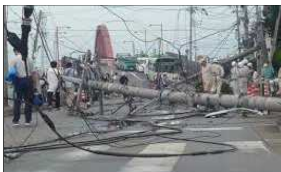
竜巻による電柱倒壊（越谷市）
