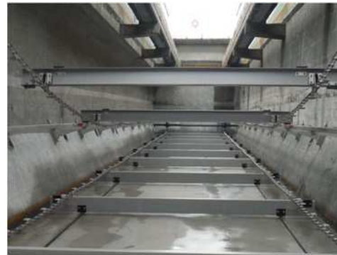
古利根川水循環センター 最終沈殿池機械設備
