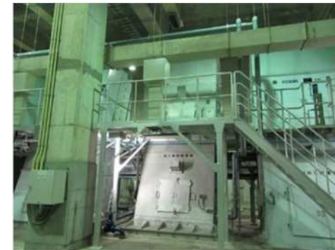
新河岸川中継ポンプ場 沈砂池機械設備
