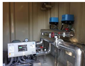
緊急遮断システム
