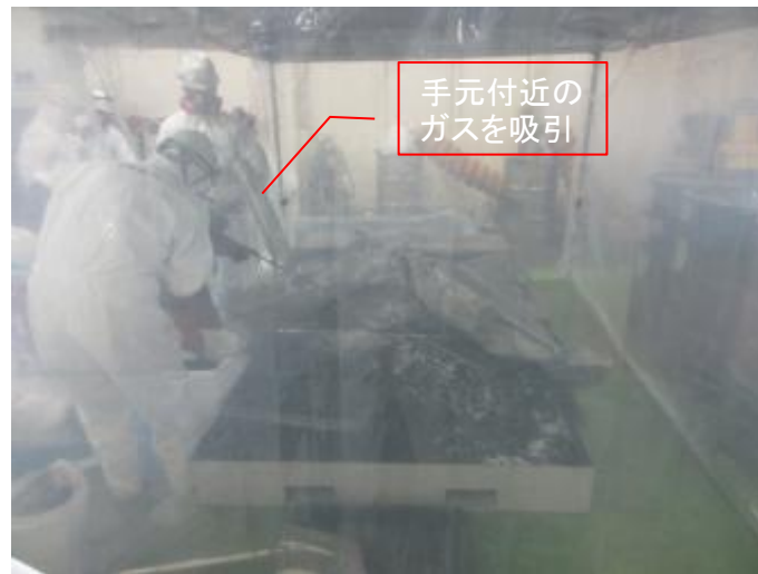
⑤ 性状確認・選別 (シート被覆、手元付近のガスを吸引)
