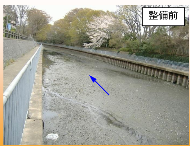
河床にヘドロが堆積している (H20.4撮影)
