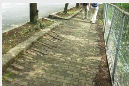
路面のゆがみ・段差
