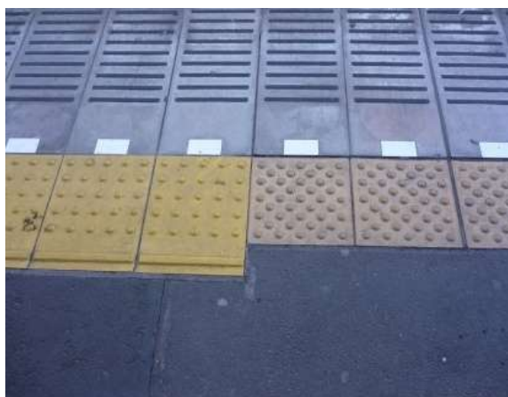
内方線付き点状ブロック
