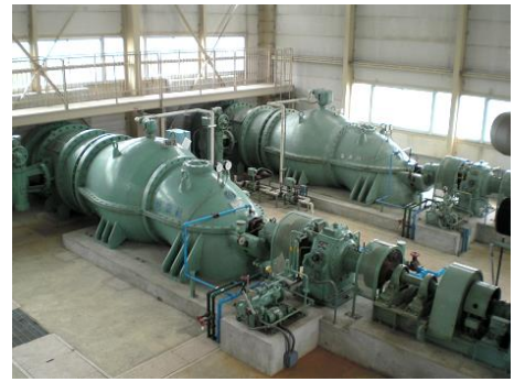
整備された排水機場
