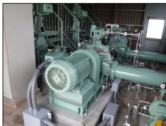
更新された用水ポンプ
