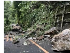
迂回路のない現道区間で落石発生
