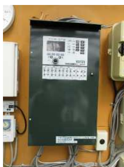
統合環境制御装置
