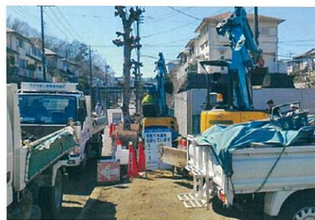
所沢市の水道管破裂の現場を調査
