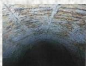
腐食した下水道管の内部
