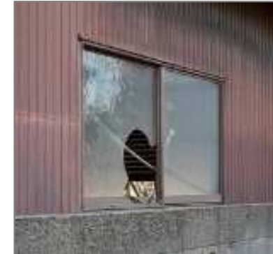
窓が割れた管理不全空家
