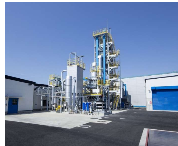
吉川再生可能エネルギーセンター
