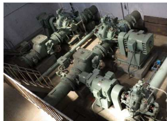
経年劣化のためポンプ設備を補修 (長楽揚水機場・川島町)
