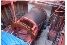
下水道施設の耐震
