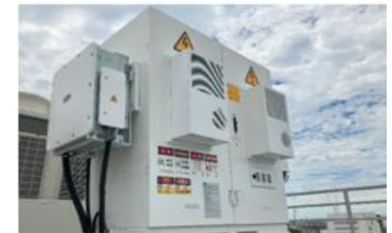
リチウムイオン型蓄電池（草加工場）
