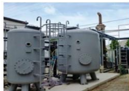
中水設備（草加工場）
