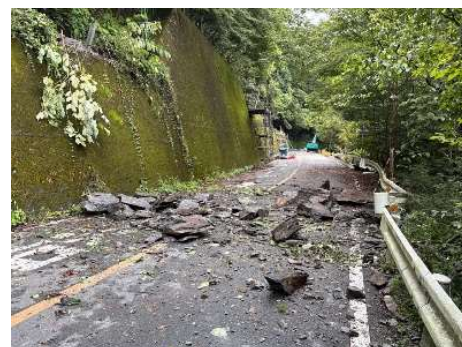
落石後の道路状況
