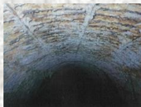
腐食した下水道管の内部
