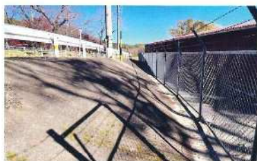
※土地改良区：用水開り防草対策工事 施工後20年経過写真
