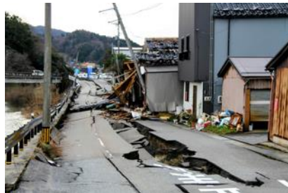
能登半島地震による被害 出典：石川県
