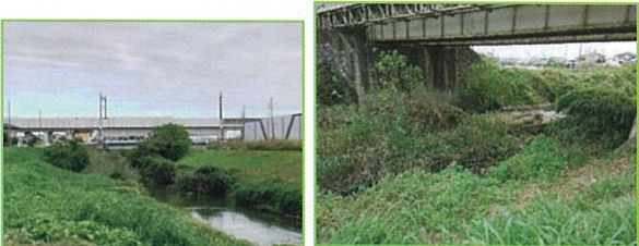
樹木が伸び、橋脚土台が残された青毛堀川
