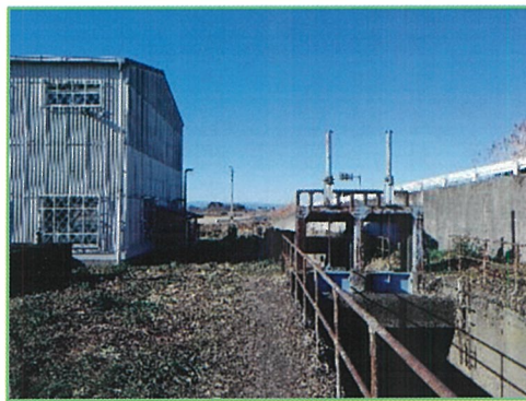
栢間排水機場の揚水機など
