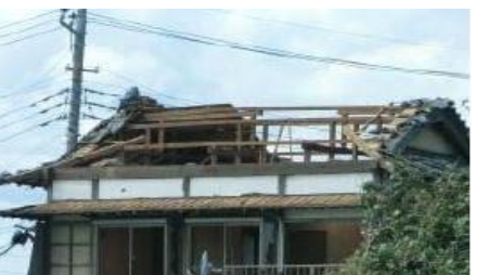
越谷市内における竜巻と家屋被害（埼玉県撮影）
