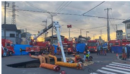
八潮市道路陥没事故現場(埼玉県撮影)
