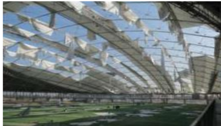
秩父市内の道路除雪と熊谷ドーム屋根の損壊(埼玉県)
