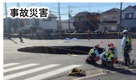
令和7年八潮市道路陥没事故現場（埼玉県撮影）
