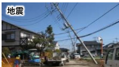
平成23年東日本大震災南栗橋液状化被害（出展：久喜市HP）
