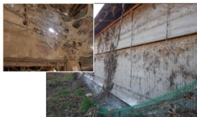
防鳥ネットの脱落と鶏舎の穴
