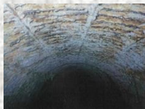
腐食した下水道管の内部
