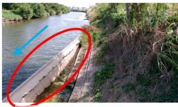
護岸ブロックの傾倒
