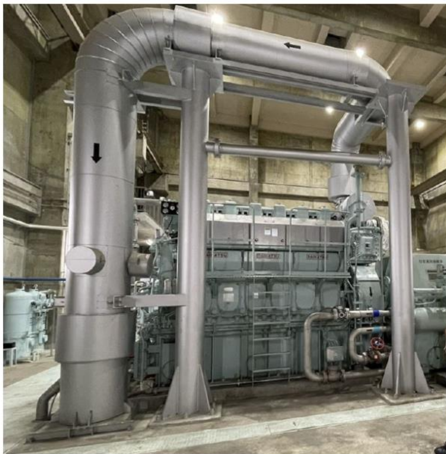
[芝川排水機場（川口市）のポンプ設備]
