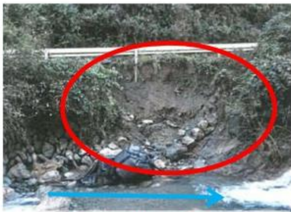
石積護岸の崩落
