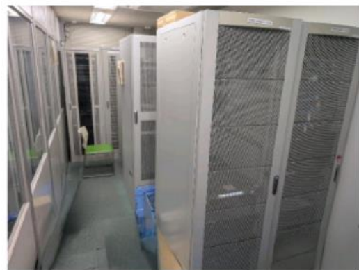
河川砂防課サーバールーム
