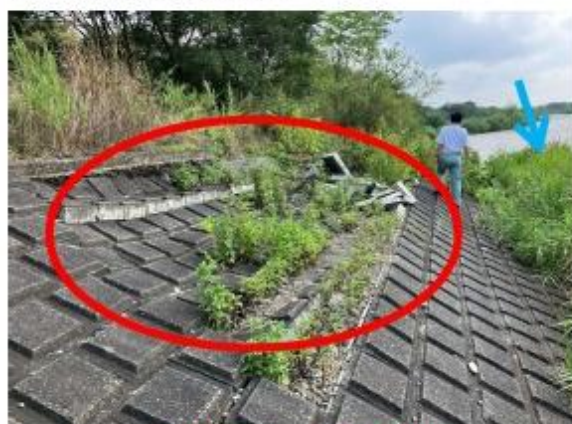
護岸ブロックの破損
