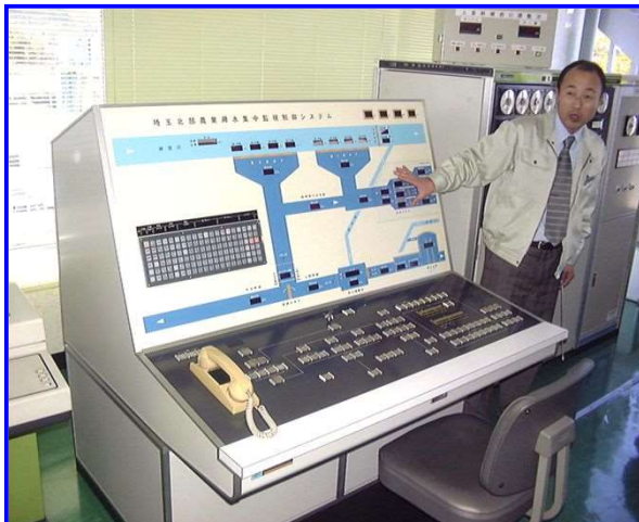
集中監視システム
