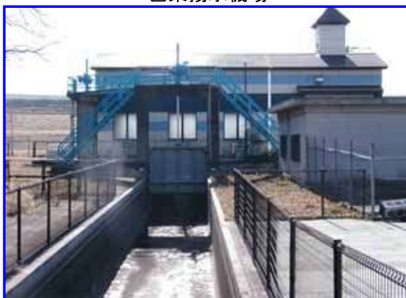
邑楽揚水機場
