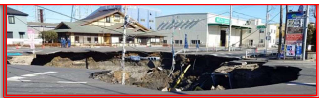
〔陥没箇所〕県道松戸草加線（中央一丁目交差点内） マンホール（チュウ4）
