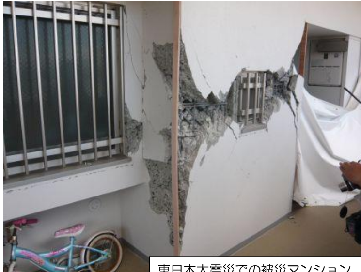
東日本大震災での被災マンション
