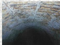
腐食した下水道管の内部
