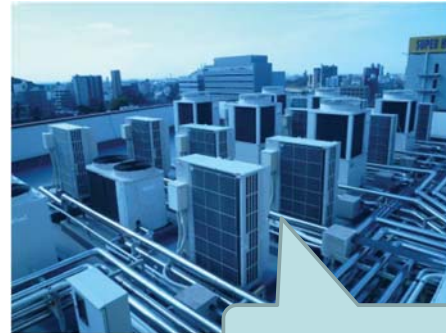
エアコン排気熱の流入
