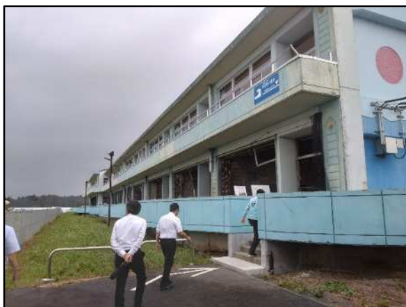
【震災遺構「請戸小学校」(浪江町)】 1階は完全に津波で水没、窓が割れている。
