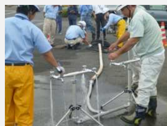
応急給水装置による給水
