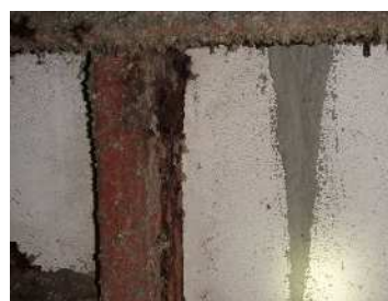
S造(防水劣化による鋼材腐食の例)
