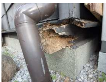
木造(露出土台の腐朽の例)
