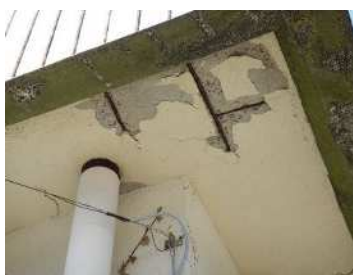
RC造(防水劣化による鉄筋露出の例)
