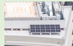
太陽光パネル
