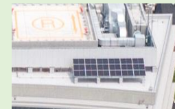
太陽光パネル
