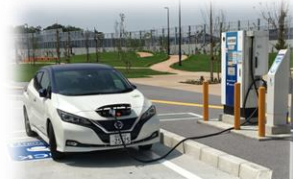
再生可能エネルギーを活用した EV充電スタンド
