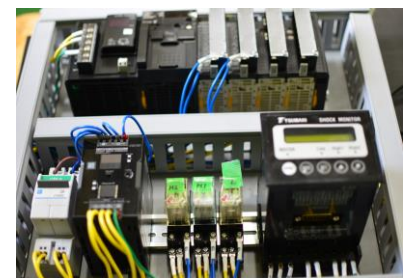
各種制御盤製作
