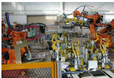
自動車 車体生産設備
