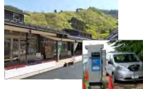
EV車等への給電設備
